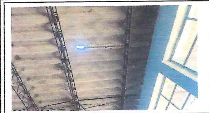
Foto 1: techo en mal estado por paso del tiempo
