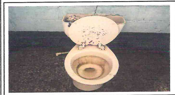
Foto 3: Sanitarios en mal estado
