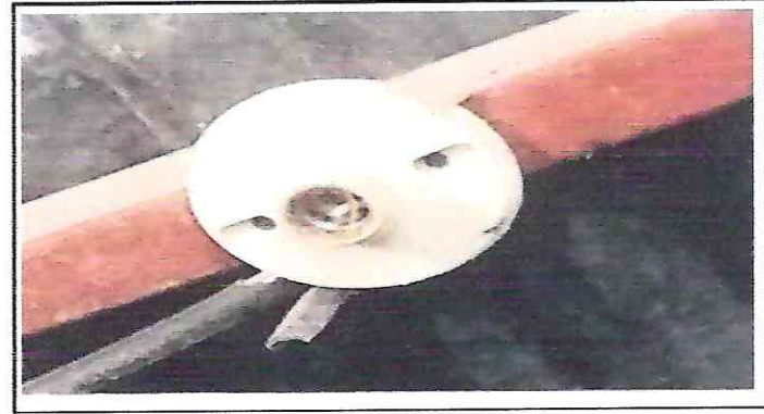
Foto 4: plafonera en mal estado
