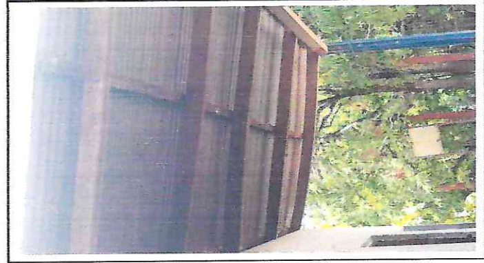
Foto 2: inestabilidad del techo por madera en mal estado
